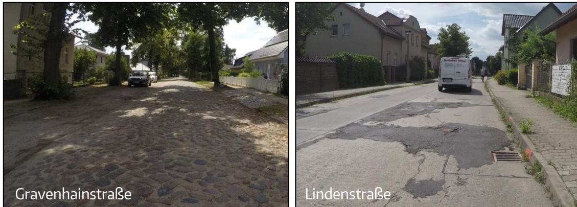
Abb. 8 Infrastruktur im Bestand - Oberflächendefizite
