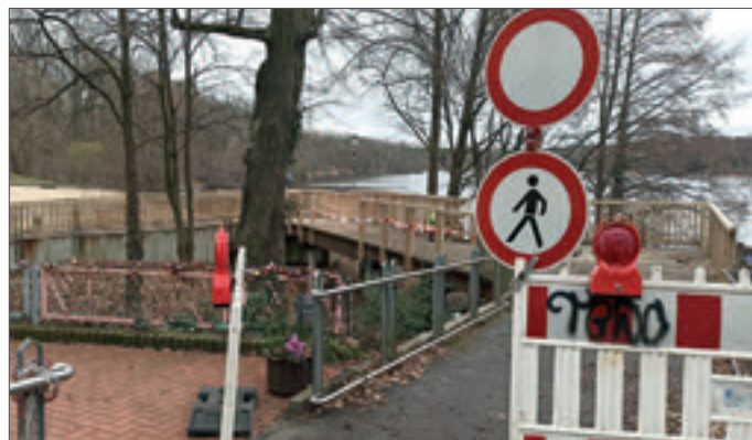
• Der Zugang zum Strandbad sowie die Steganlage werden bis zum Beginn der Badesaison saniert. Foto: K. Brandau
