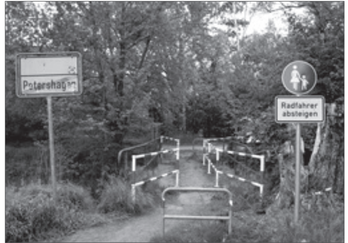
• Momentan kann man die Brücke einzeln betreten. Radfahrer müssen absteigen. Foto: K. Brandau
