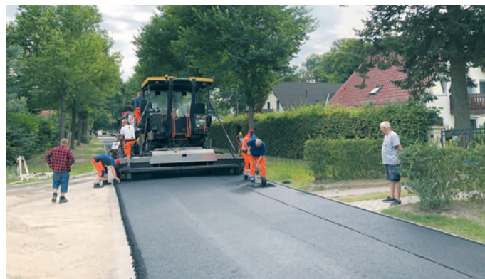
● Asphalt für die Wiesenstraße: Mitte August wurde in der Wiesenstraße im Ortsteil Petershagen die letzte Schicht Asphalt aufgebracht. Nun ist die Straße fertig und die Sandpiste passé. Foto: K. Brandau
