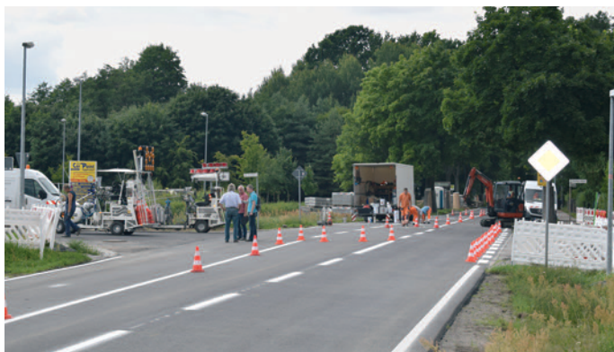
● In der Kreisstraße Petershagener Chaus-see/Eggersdorfer Straße war im August die Fahrbahn erneuert worden. Nun zieht die Baustelle Richtung Petershagen. Dort müssen die Abläufe erneuert werden. Foto: K. Brandau
