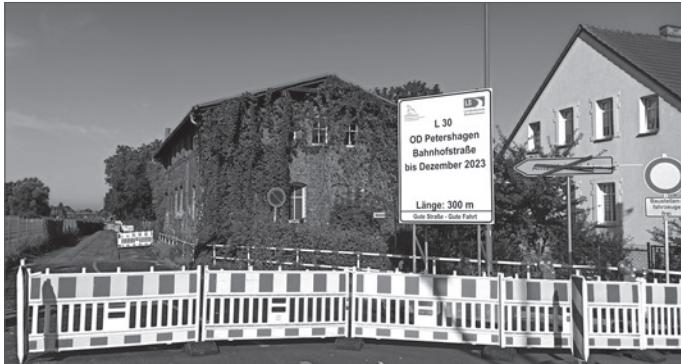
● Im August ging's los: Die Bahnhofstraße wird endlich saniert. Foto: K. Brandau
