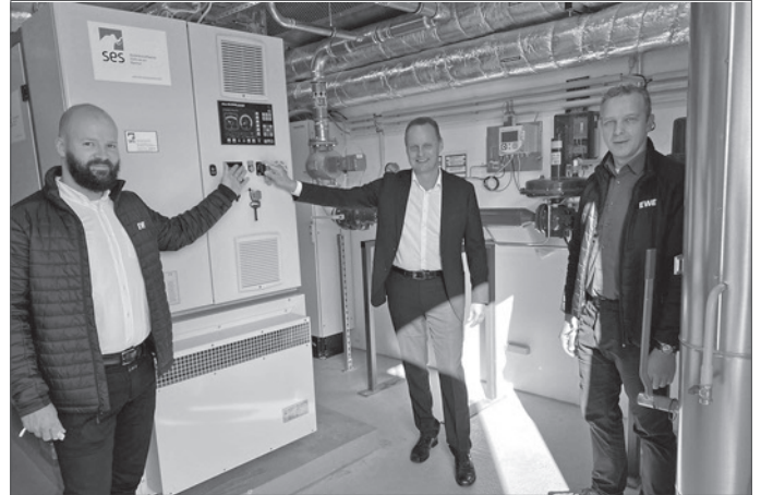
● Auf Knopfdruck geht's ans Netz: Sebastian Siewers von der EWE (li.) und Bürgermeister Marco Rutter nehmen das neue Blockheizkraftwerk in Betrieb. Foto: N. Auras
